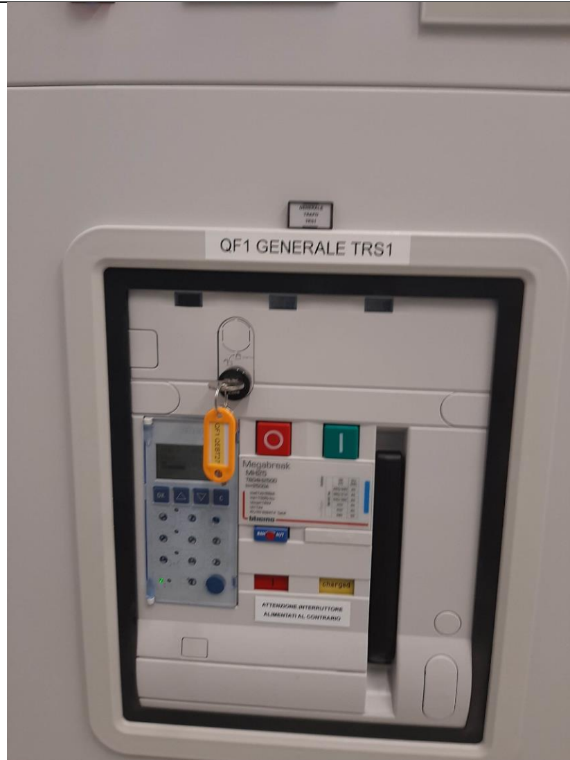
Quadro elettrico generale Magazzino 27
