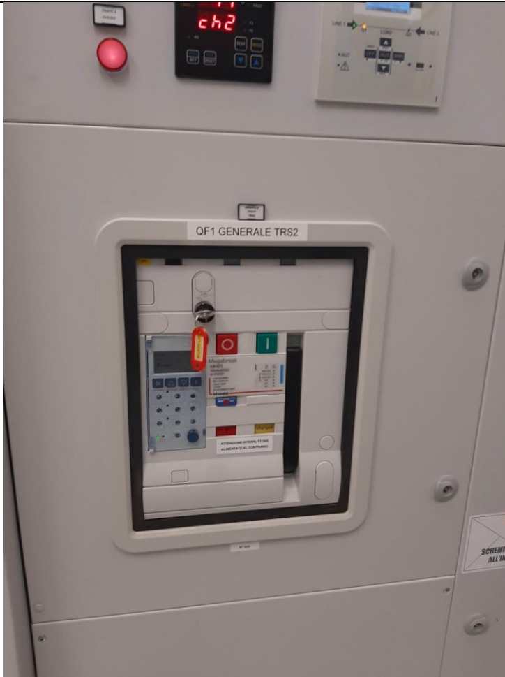
Quadro elettrico generale Magazzino 28
