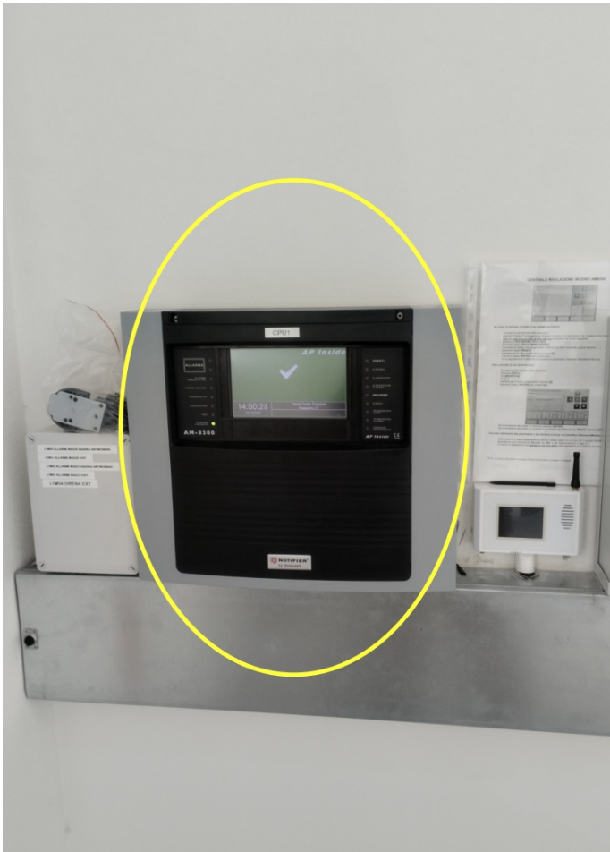
Centrale rivelazione incendi
