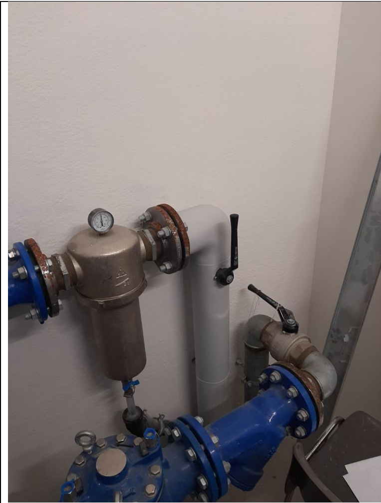
Valvole di intercettazione dell'impianto idrico del Magazzino 27
